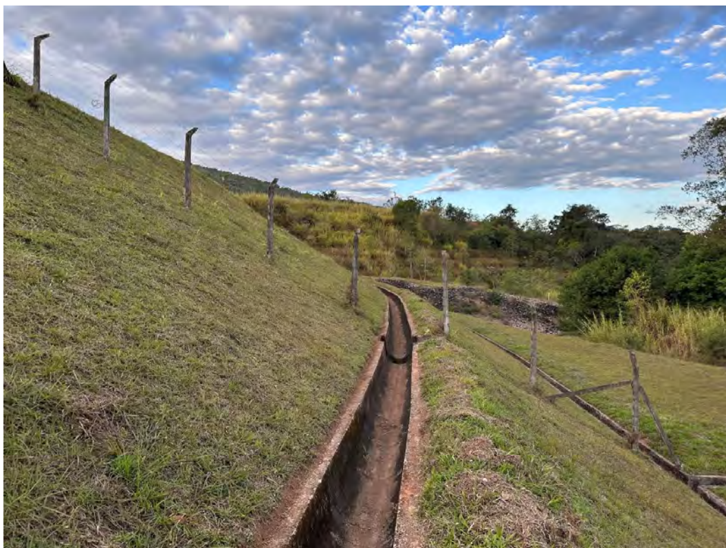
Foto 11 – Talude de jusante. Berma da cota 927 m - Vista para a ombreira esquerda.
