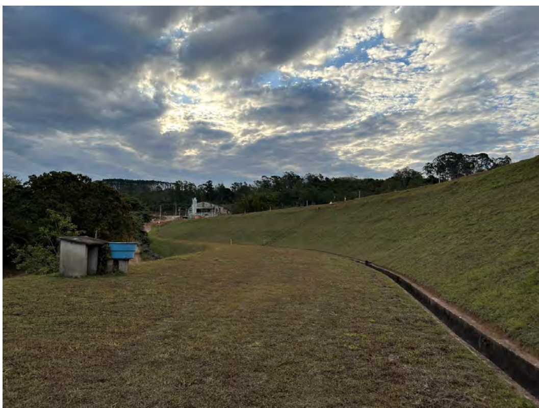
Foto 14 – Talude de jusante. Berma da cota 924 m - Vista para a ombreira direita.
